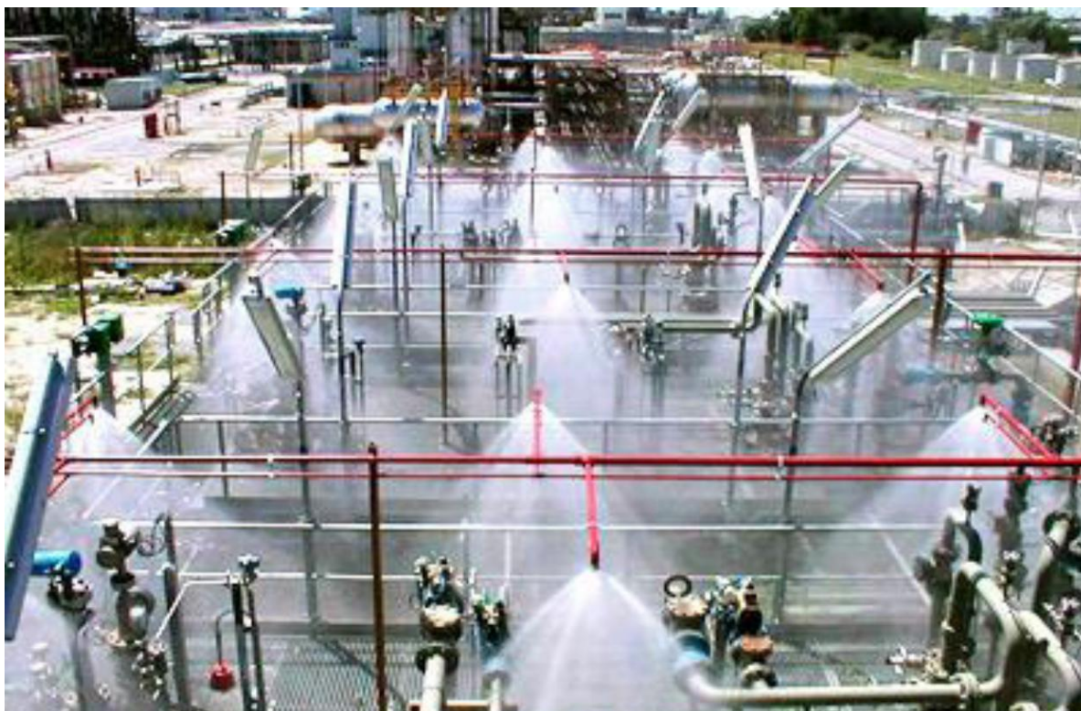
Рисунок 4 - Автоматическая установка водяного пожаротушения
