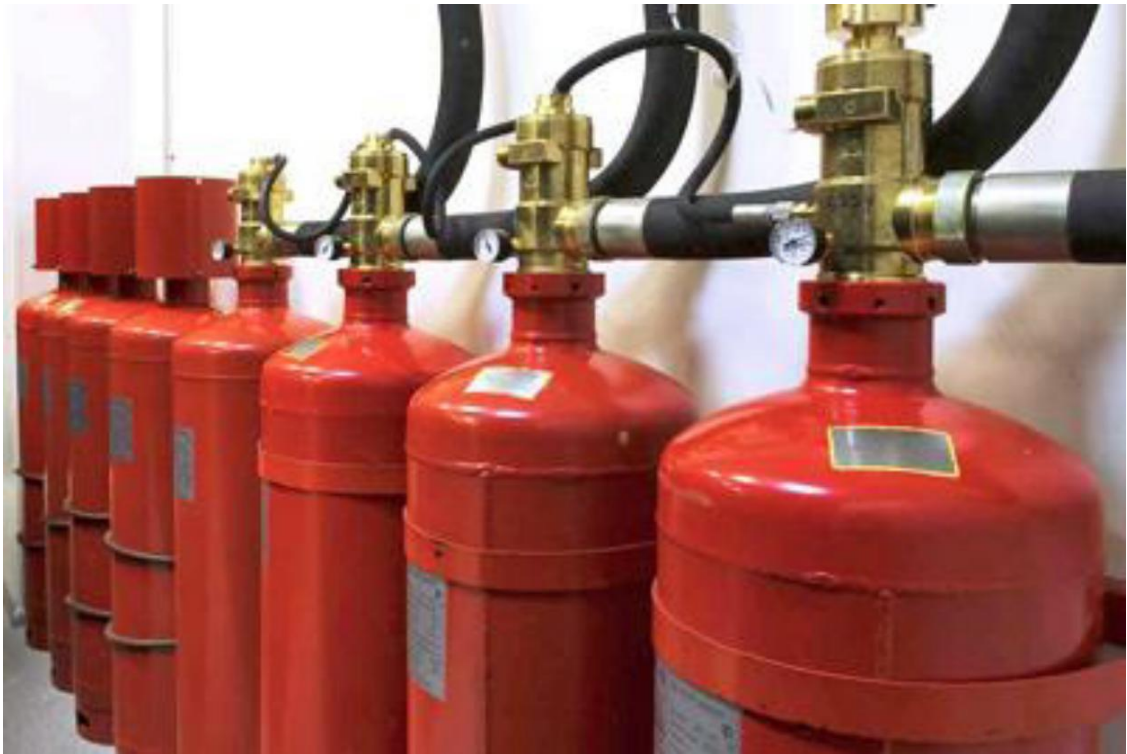
Рисунок 1 - Установка газового пожаротушения
