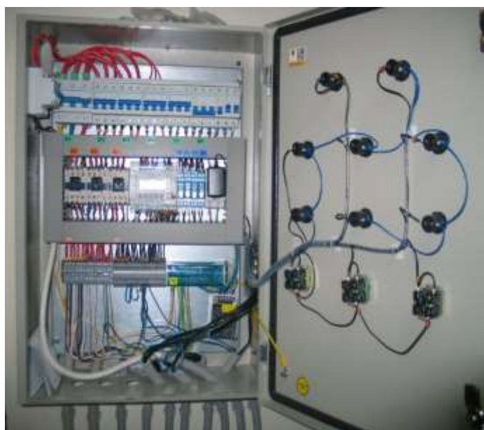
Рисунок 5 – Шкаф автоматического управления вентиляцией
