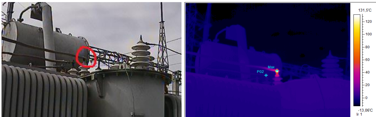
Рисунок 6 - Аварийный нагрев болтового соединения ввода 35 кВ низкой стороны напряжения по фазе А (ПС 35кВ Ким. Трансформатор 35 кВ Т2. Сторона НН. Фаза А).
